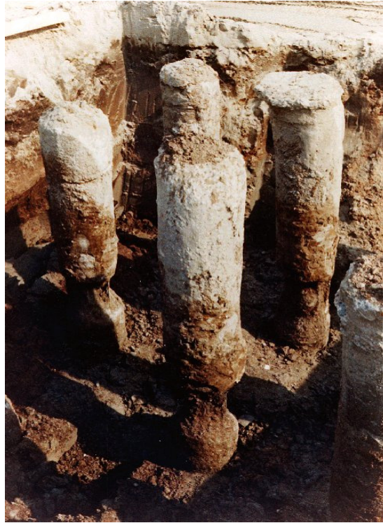
Pfähle mit starken Einschnürungen
